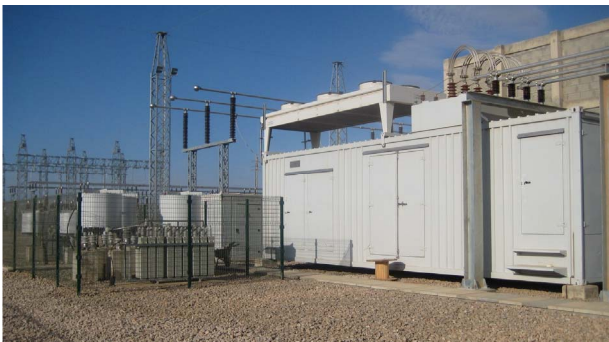
Общий вид регулятора УШРТ на ПС Самата
